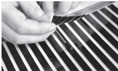
Рис. 16. Датчик прикрепляется к термопленке битумной изоляцией
